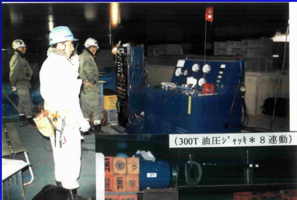
ポンツーン下閉合設備 (荷重/変位油圧ジャッキ設備)
